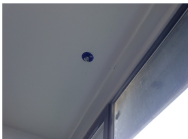
Punto de anclaje instalado para la realización de los trabajos de limpieza de cristales de la escalera principal
