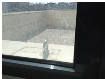
Punto de anclaje instalado para la limpieza de cristales de la terraza situada en la primera planta
